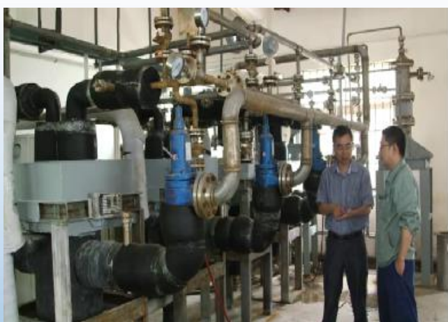
四氟化硅高纯气体中式装置
